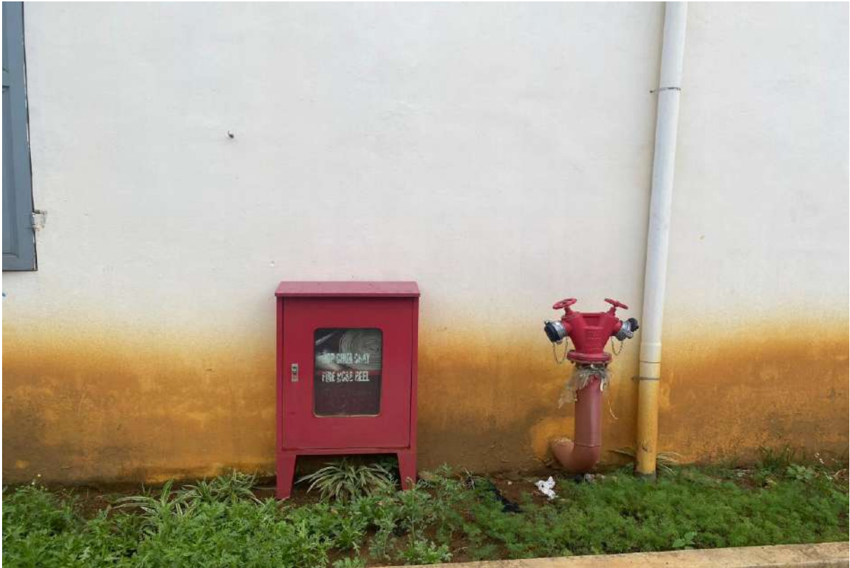
Hình 12. Thiết bị bình chữa cháy tại Nhà máy
